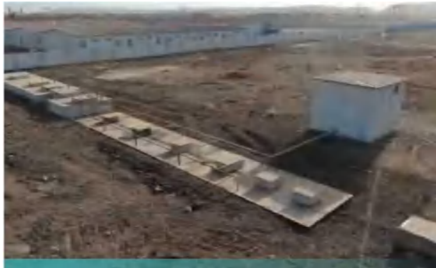
中材建设塞内加尔 SC3 项目污水处理设施
